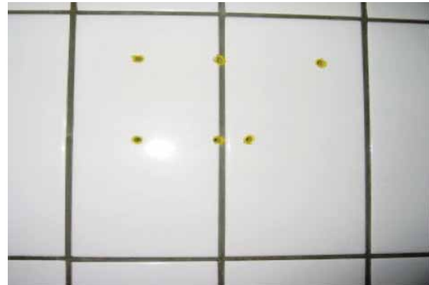
Borehuller i fliser på badeværelse.
